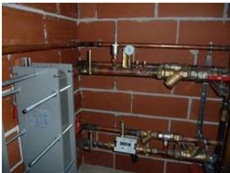
9 Sous station de distribution de la chaleur au niveau de chaque exploitation (échangeur à plaque)
