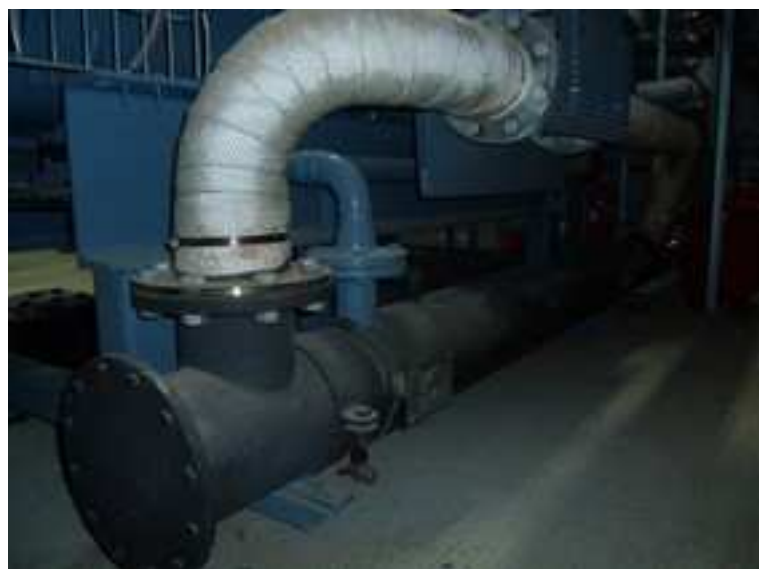
8 Echangeur tubulaire pour récupérer la chaleur sur les gaz d'échappement du cogénérateur
